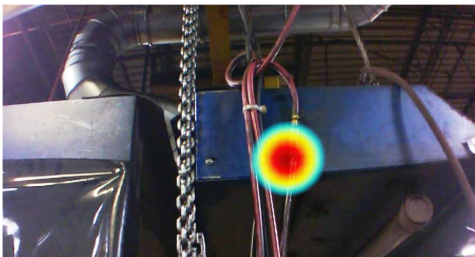
在工業環境中使用 ii900 工業聲波成像儀所拍攝的氣體洩漏影像。
